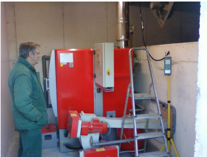
Foto 1: de Hargassner ketel met de voeding uit de bunker rechts
